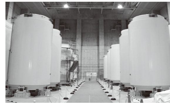
出典: 電気事業連合会パンフレット「乾式貯蔵施設」日本原子力発電(株)東海第二発電所
