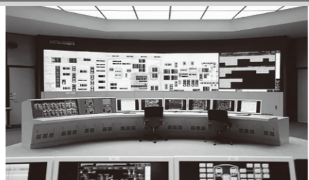
中央制御盤を最新設計のデジタル式に取替え
